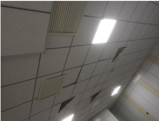
机房内部顶棚现状
