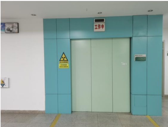
机房防护门现状
